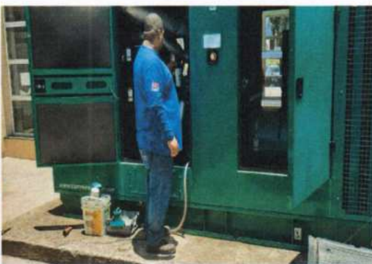
5- PREVENTIVA DE GERADOR V.CRISTINA
