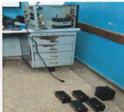
11-TROCA DE BATERIAS NOBREAKS
