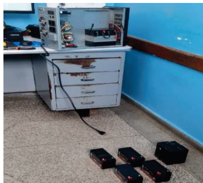
11-TROCA DE BATERIAS NOBREAKS
