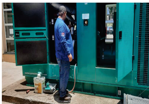
5- PREVENTIVA DE GERADOR V.CRISTINA
